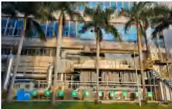
废气治理设备
