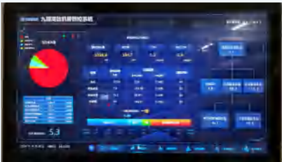
珠海总部空调机房能效提升
