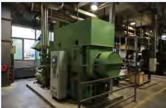
珠海总部空压站能效提升
