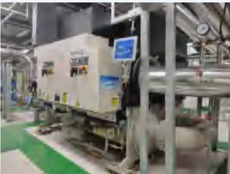
深圳地铁空调机组
